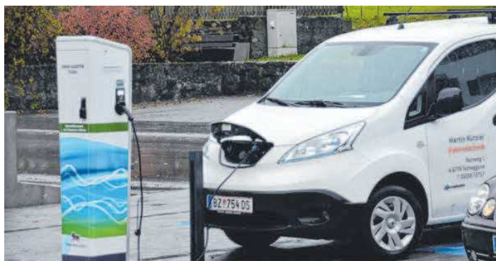
Auf dem Gemeindevorplatz wurde eine Doppelladestation errichtet.
