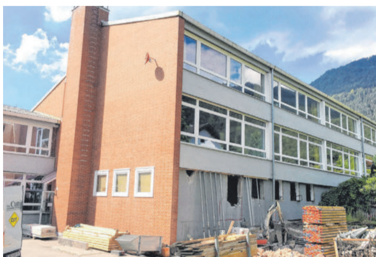
Die Arbeiten am Zubau bei der Volksschule Obdorf wurden gestern in Angriff genommen. VN/JS
