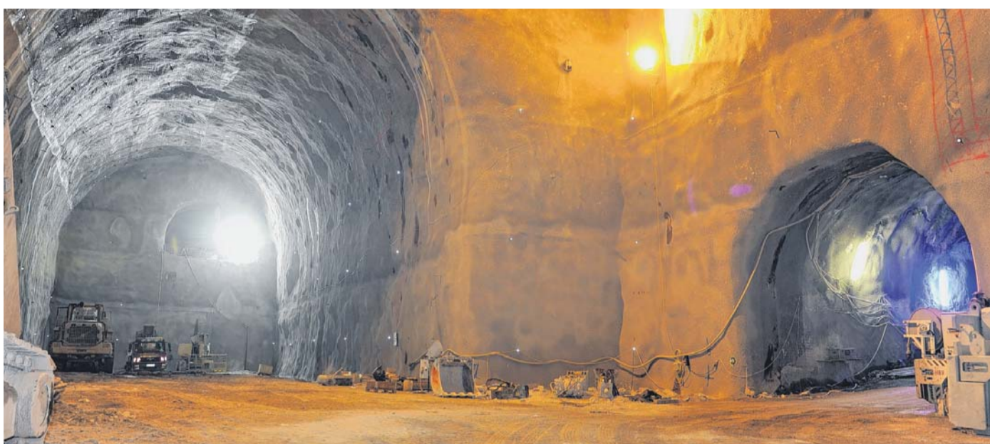
Die Arbeiten im beeindruckenden Stollen des Werkes Obervermunt II gehen auch im Winter weiter.
