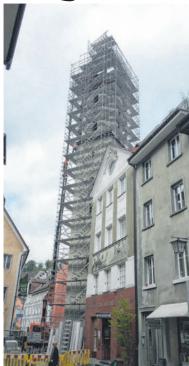
Von diesem Gerüst stürzte der 20-Jährige in den Tod. Foto: Schweigkofler
